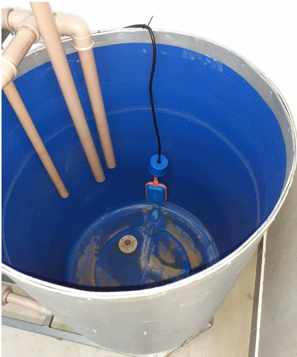
Figura 4. Chave tipo boia instalada em um dos tanques.
