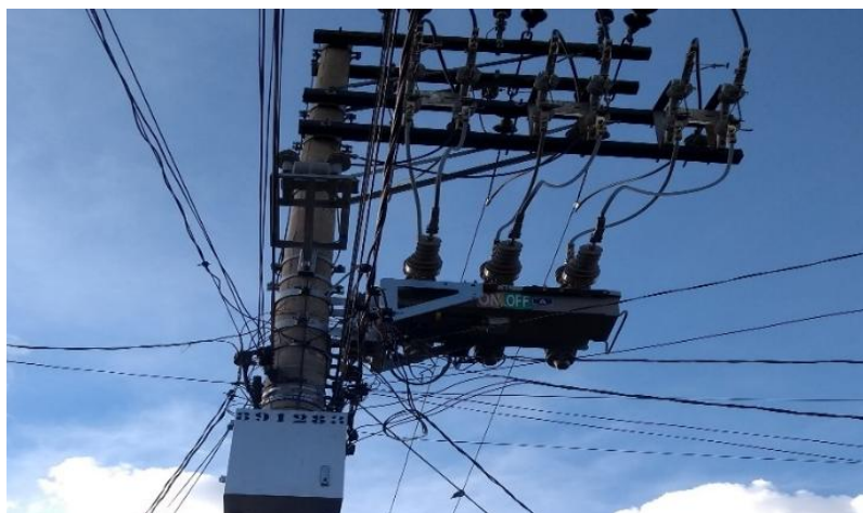
Figura 5: RA instalado na rede elétrica da CPFL.
