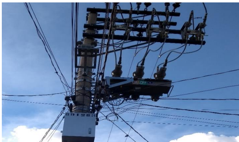
Figura 5: RA instalado na rede elétrica da CPFL.
