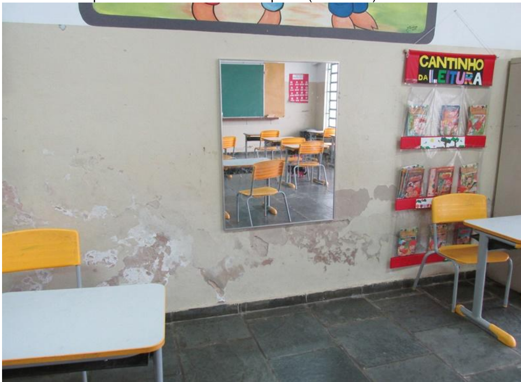
FIGURA 2: Espelho Fixado de forma inadequada (Escola 07)
